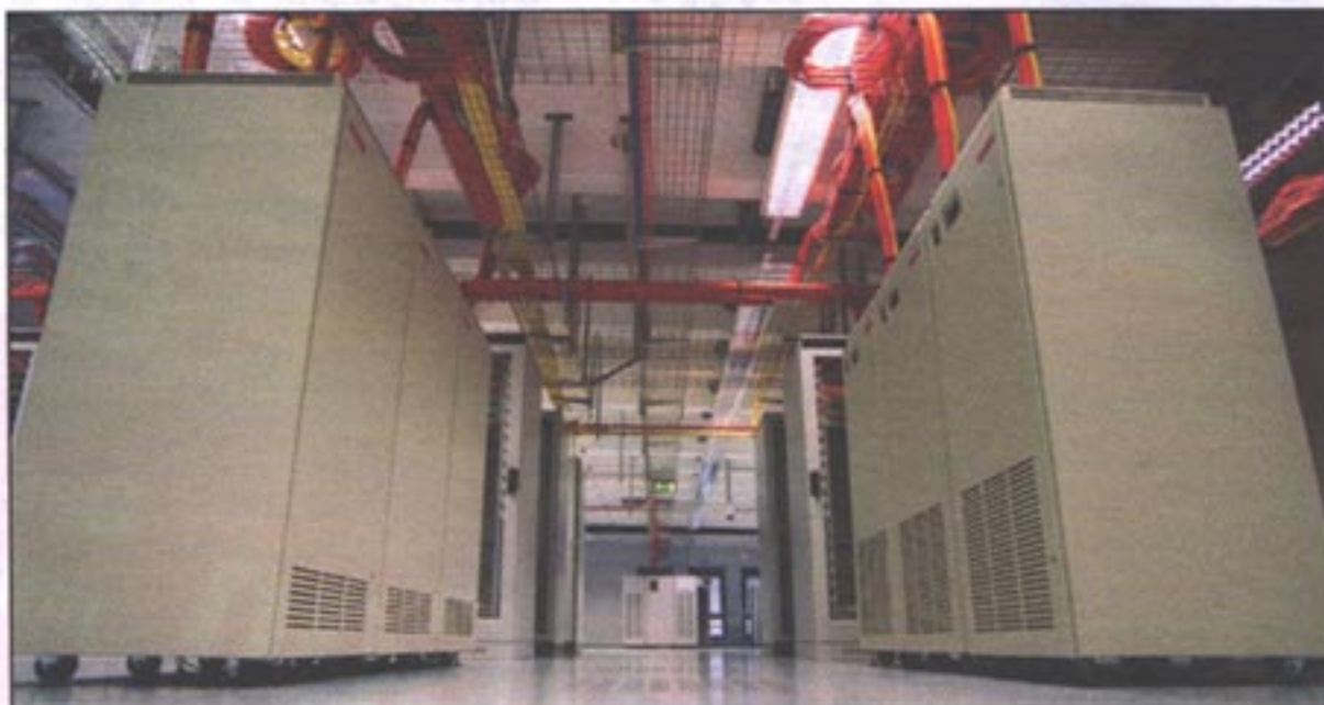
Das Data Center eines professionellen Hosters ist ein Areal modernster Technik.
