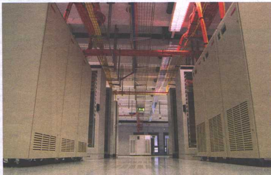
Technik, die begeistert: Blick in ein Data Center eines professionellen Hosters.
